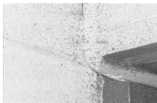
写真3. 壁面かどの脱糞跡
