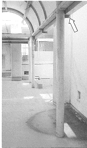
写真13. 渡り廊下樋にボウフラ大量発生(100匹以上)
