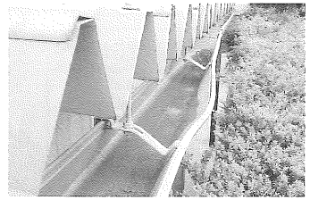
写真11. 樋にボウフラ大量発生(100匹以上)
