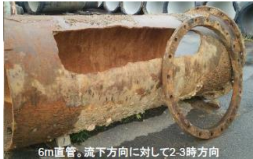
6m直管。流下方向に対して2-3時方向
